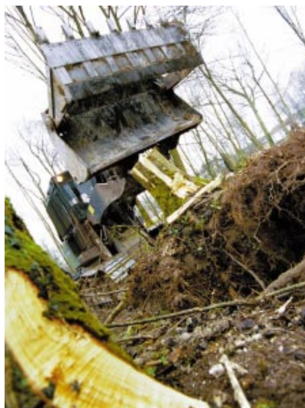
Engin du génie au cours des travaux de déblaiement après les intempéries de décembre 1999.
