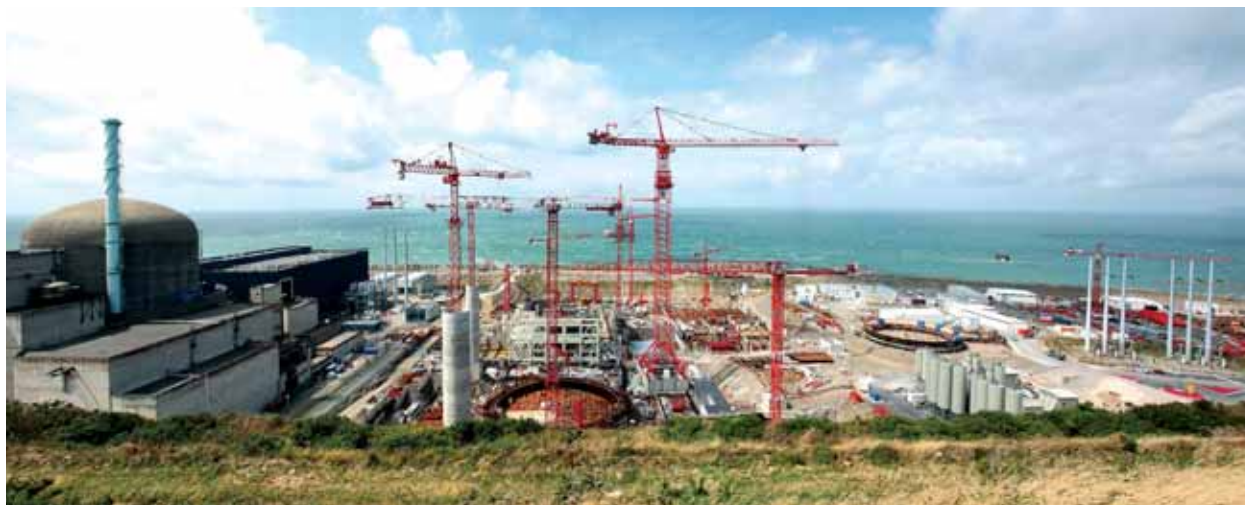
Lors des inspections menées par l'ASN, les experts de l'IRSN ont relevé des non-conformités sur le chantier de l'EPR.
