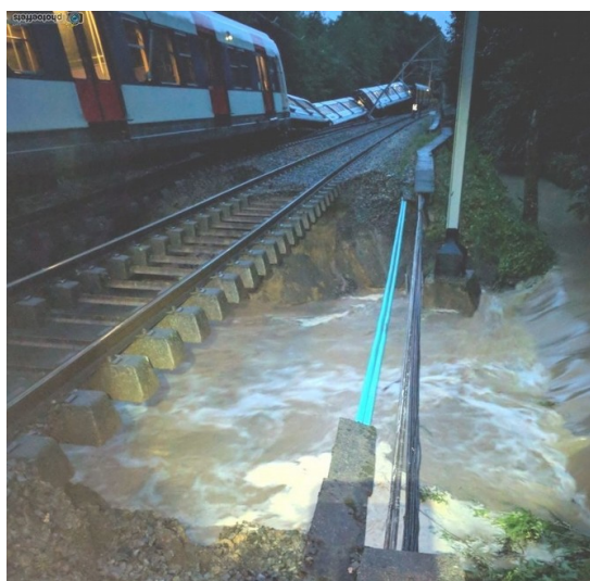
Vue 14 : la brèche de l'accident
