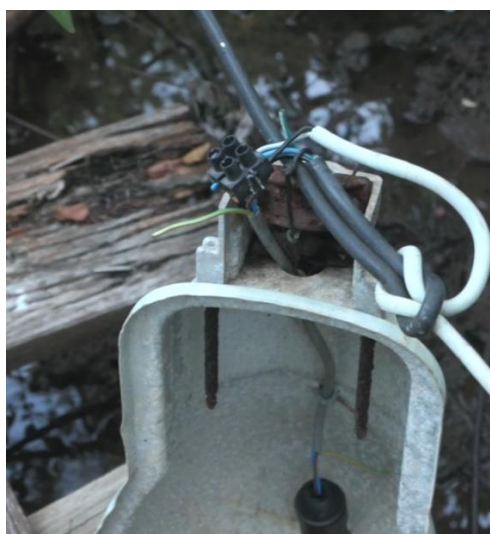
Raccordement électrique en pleine mangrove ...
