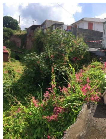
... érosion du talus côté terre,
