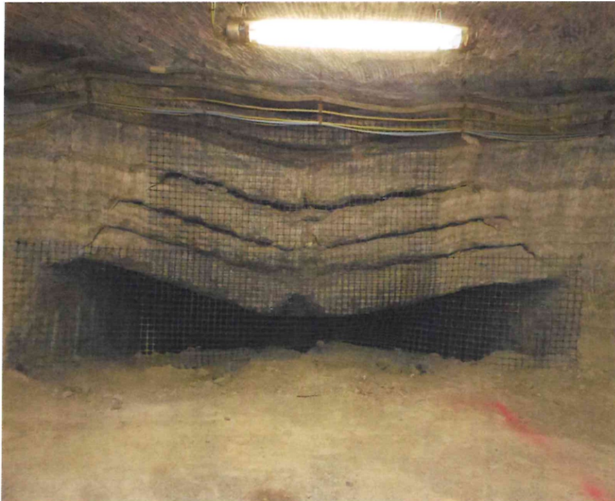
Photo n° 1 : Illustration d'un bloc fortement dégradé avec décollement du toit (bloc 25)
