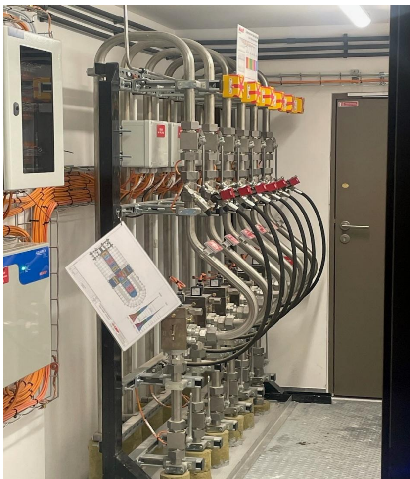
Photo n° 3 : dispositif de sécurité incendie
