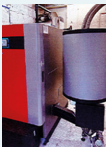
Installation de la chaudière à pellets à la Faisanderie de Sénart à Étiolles (91), ministère de l'Agriculture
