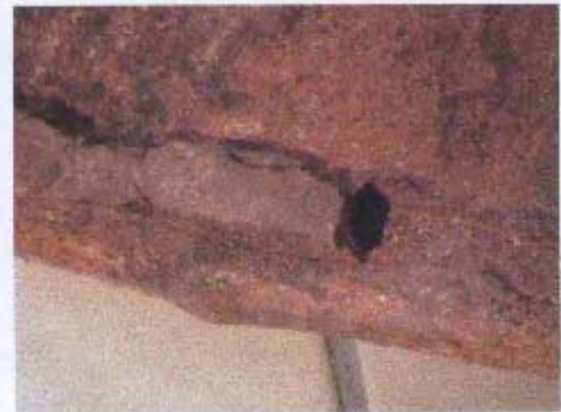
Fissure pied de cordon.
