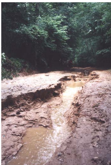
Voirie défoncée dans le talweg sec
