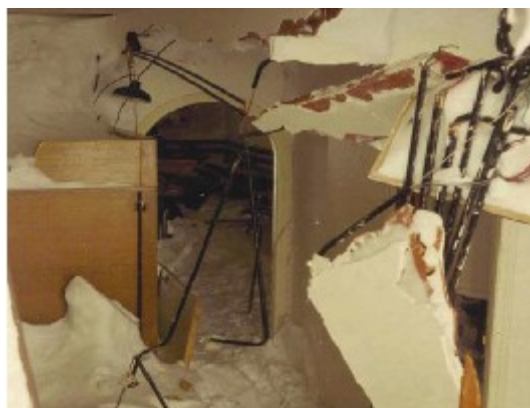
Barèges, avalanche en aérosol du 31 janvier 1986, dégâts sur l'immeuble « le Schuss »
