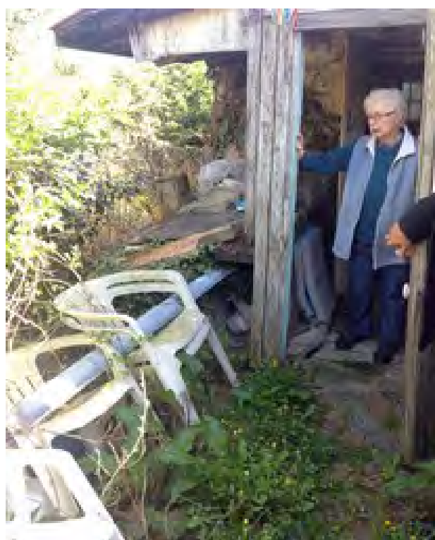
Affaissement d'une terrasse au 409 (photo mission)
