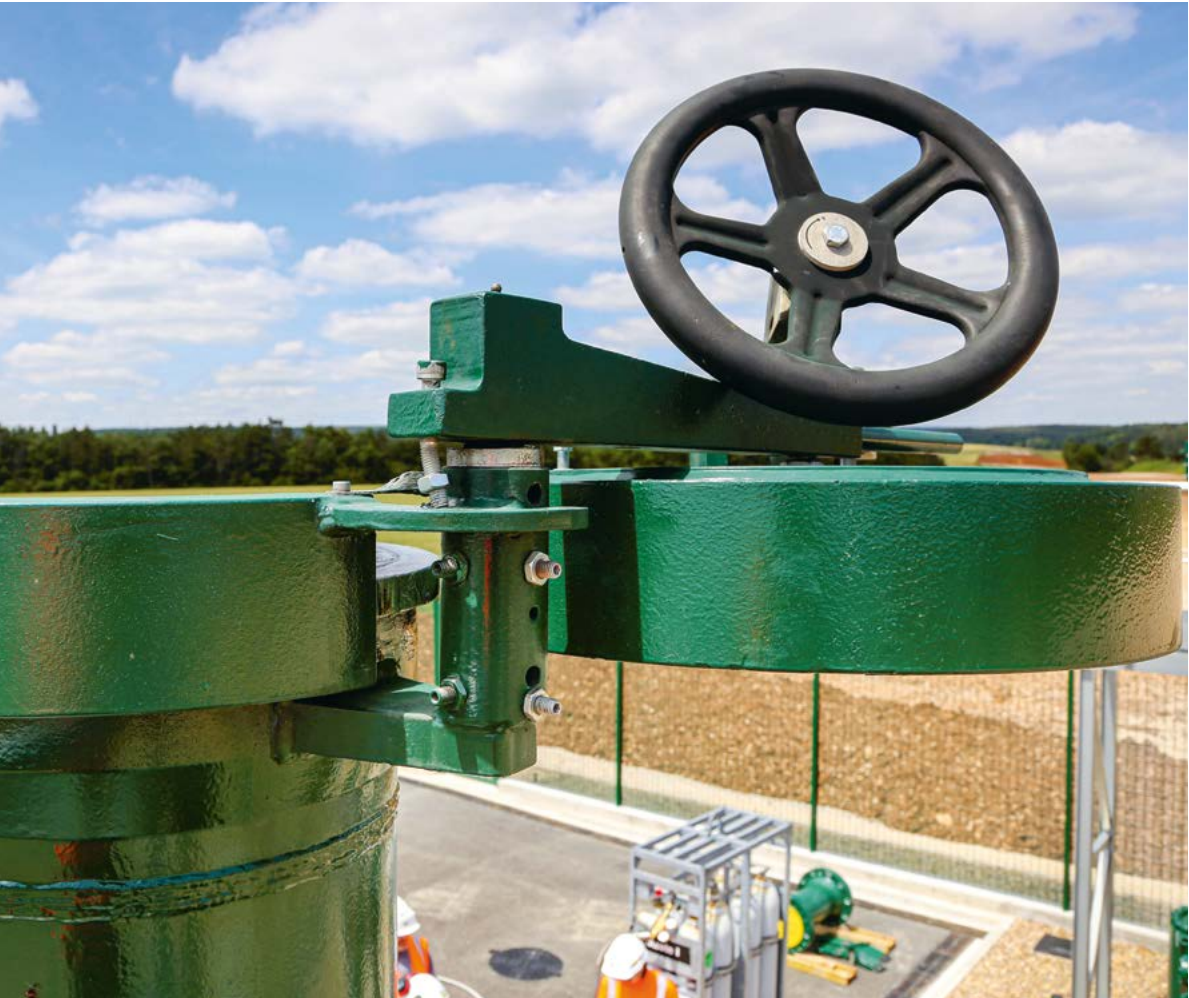
Poste de sectionnement. © GRTgaz/AGENCE COM'AIR
