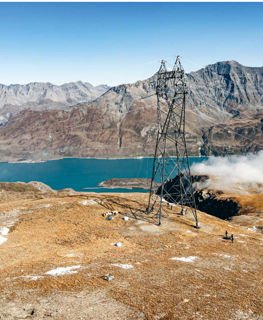
La ligne 400 000 volts reliant Villarodin, près de Modane, en Savoie, à Vénau, près de Turin, en Italie. C'est l'une des quatre lignes stratégiques entre la France et l'Italie. © Seignette Lafontan
