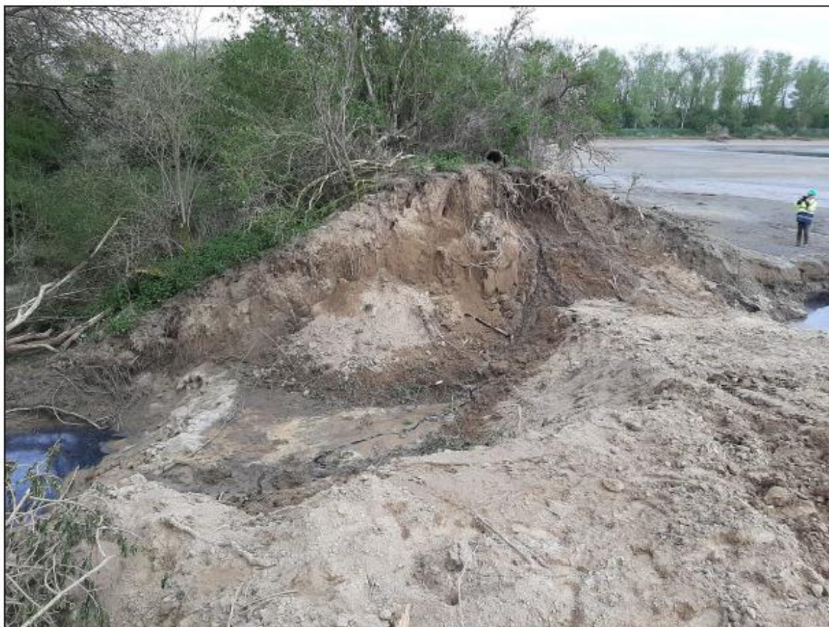
Figure 11: bassin Iwuy canal, rupture de la digue sud (source rapport Antea Group, inspection visuelle du 14 avril 2020)
